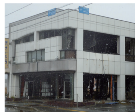
東日本大震災で発生した津波に、2階の屋根上までのまれた本社店舗
